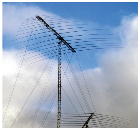
Obr. 3. Mohutné LPD antény na KV najdeme v areálu MZV v Praze
